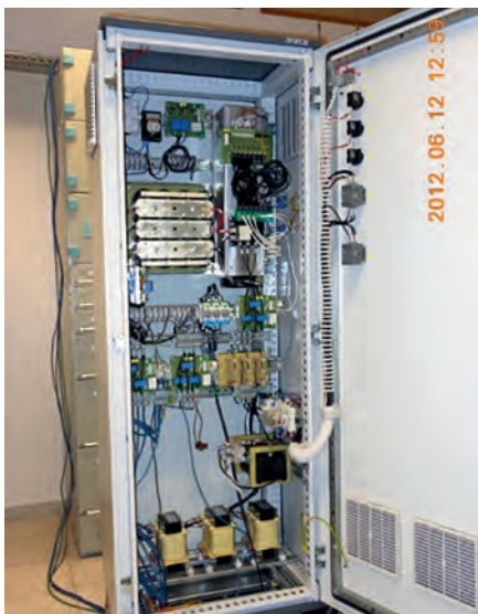
Rys. 2. Widok aktywnego filtra mocy wykonanego w ramach projektu
