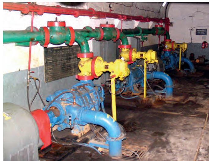
Fot. 6. Pompownia w kopalni Wujek
