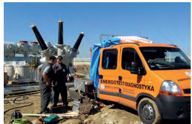
Fot. 9. Badania po montażu rozdzielni 110 kV typu GIS SF6 zasilającą zakład produkcyjny LG pod Wrocławiem
