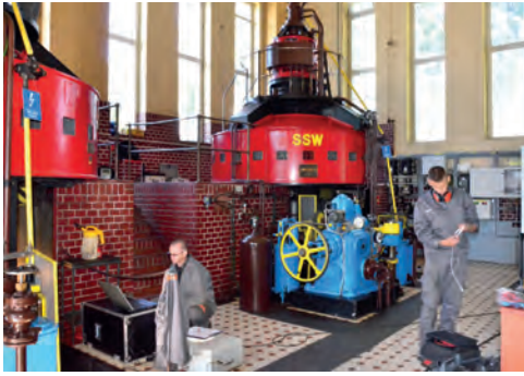
Fot. 5. Pomiary hydrogeneratorów w elektrowni wodnej Włodzice na Dolnym Śląsku
