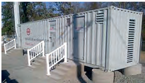
Fot. 15. Magazyn wielkoskalowy firmy BYD [25]
