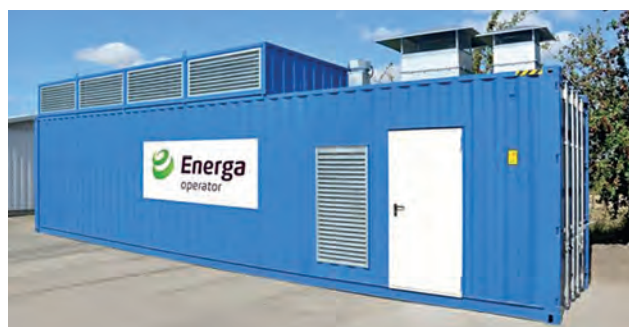
Fot. 17. Kontenerowy magazyn zainstalowany w Energa-Operator [24, 25]
