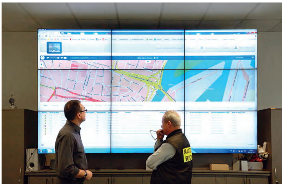
Fot. 3. Centrum dyspozytorskie Szczecin
